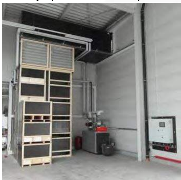
Vista de la instalación de secado para 2 secciones con calefacción central.
