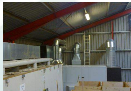
Conducto de aire conectado a un nuevo secador de aire de adsorción.
