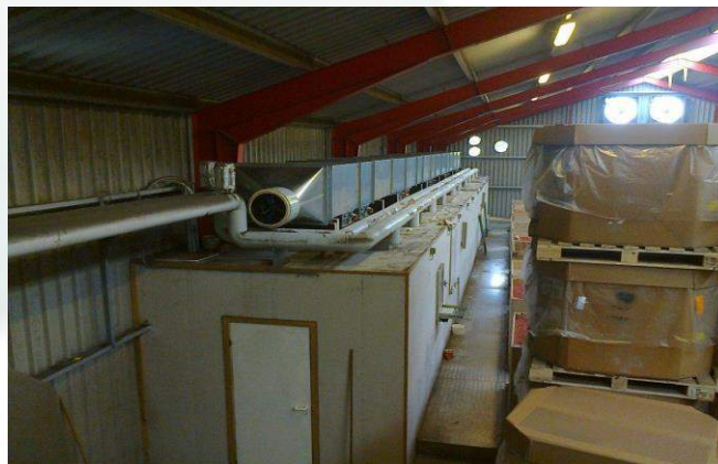
La instalación de secado después de modificación; cada fila de cajas incluirá un suministro individual de aire deshidratado.
