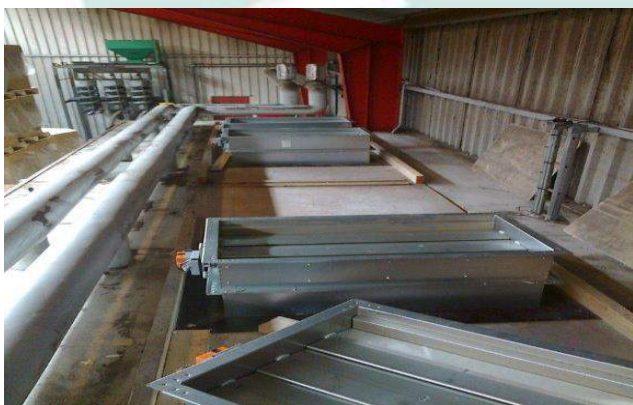
Techo de instalación de secado existente; instalación de registros de válvulas para el aire seco por fila/ventilador.
