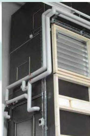
Conexión de tubos al radiador dentro del sistema de distribución de aire.
