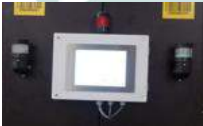
El proceso será programada y controlado por un panel de control con pantalla táctil y ABC software.
