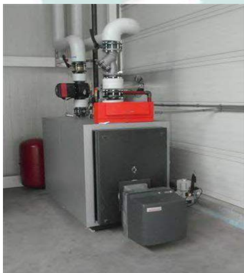
Ejemplo de una caldera para la calefacción central de 2 secciones.
