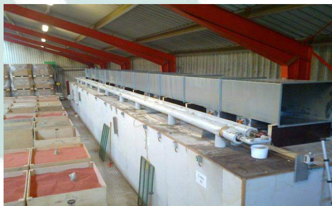
Conducto de distribución de aire encima de los registros de válvulas. El aire del secador de aire será distribuido a cada sección de secado.
