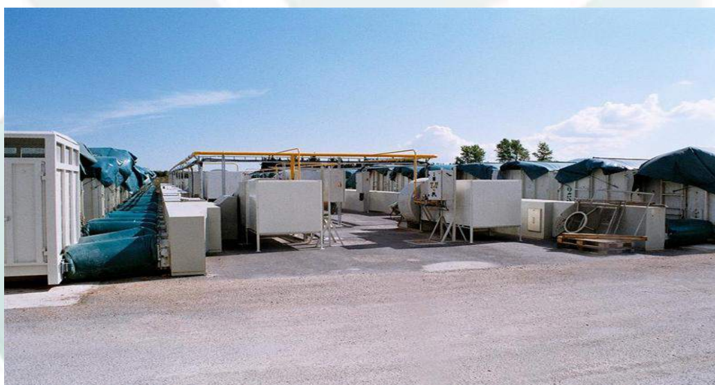
Secciones de secado con ventilador, canal de distribución de aire y las conexiones con los contenedores.
