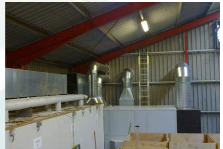
Luchtkanaal aangesloten op een nieuwe adsorptie luchtdroger.
